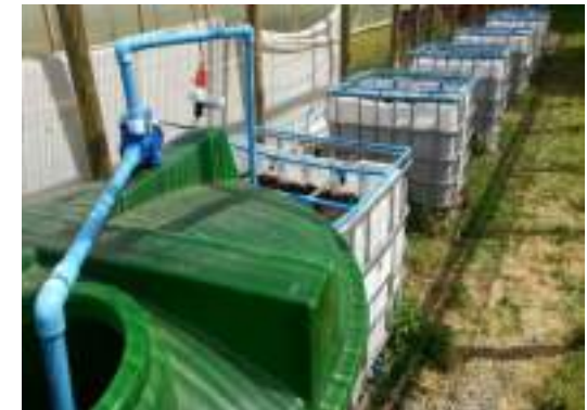
Tratamiento para aguas contaminadas
